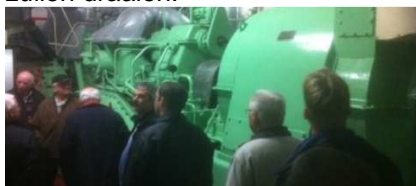
Elektriciteitscentrale aan boord
