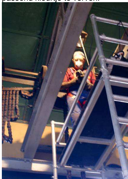
Hoog in de Machinekamer is Hans druk doende met het schoon maken en inspecteren van de hijsinstallatie
